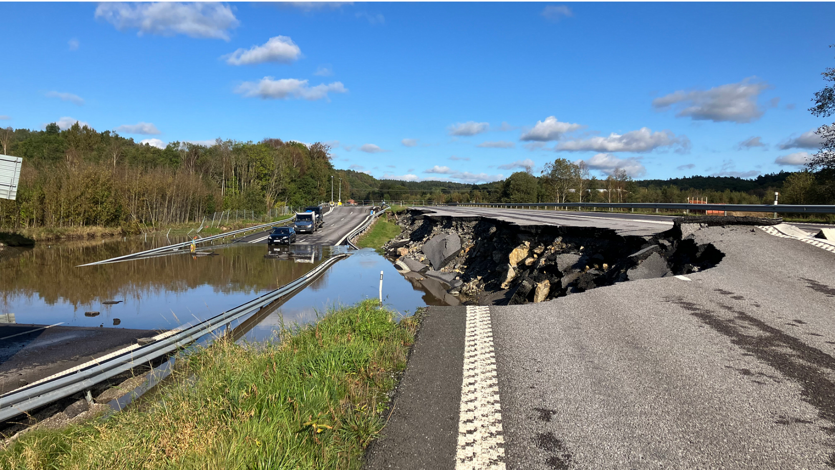
Jordskredet i Stenungsund 2023. Foto: Jonas Axelsson, Trafikverket.
